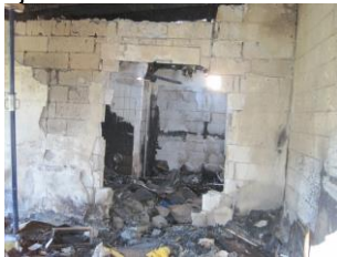
Huset er helt udbrændt
