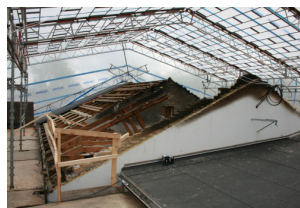
Den beskadigede tagkonstruktion
