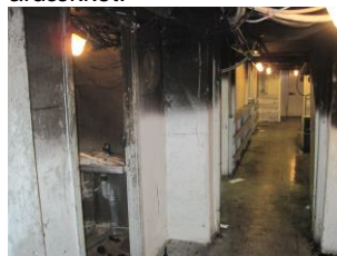
Sodskader i kælder.
