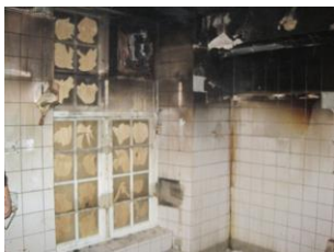
Sodskader i kælder.
