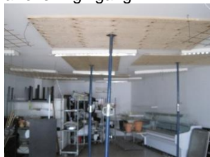
Afstivning af konstruktionen nødvendig
