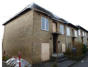
Enderækkehuset, hvor branden opstod.
