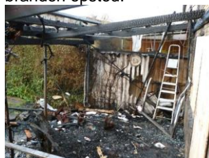
Overdækket terrasse udbrændt.
