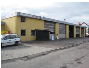
Fjerneste ende af bygningen er kollapsede.
