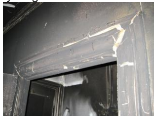
Røg, sod og varme-påvirkning af træværket.
