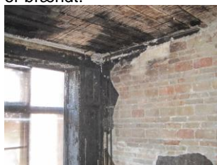
Omfattende ødelæggelser i stue.
